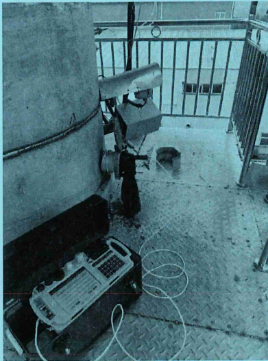
锅炉废气处理后排放口 DA001
