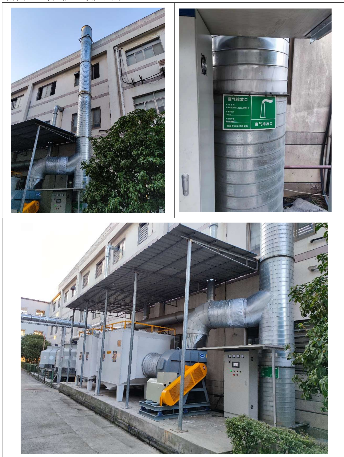
本项目二级活性炭吸附装置及排气筒
